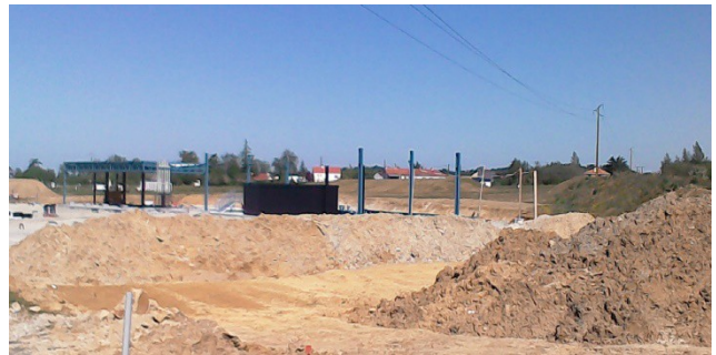
Reprise des travaux de construction de la station-service pendant le confinement (photo du 17 avril 2020)
